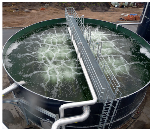
In einem offenen Reaktor wird industrielles Abwasser gereinigt.
